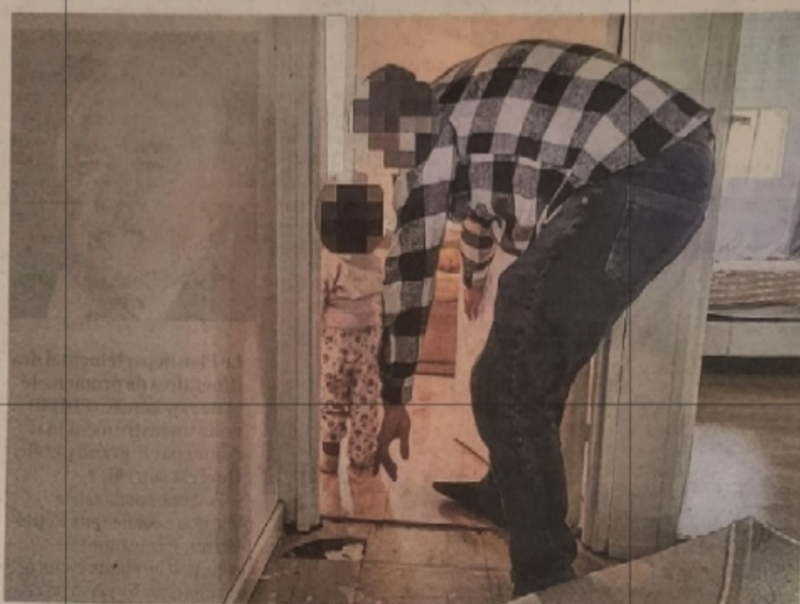
Le revêtement du palier de l'habitation, particulièrement dégradé, libère de l'amiante dans l'air ambiant. Photo Adrien Jacquot
