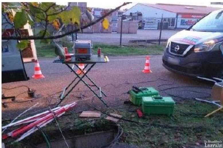
Des réparations sont en cours. Le réseau est rétabli au fur et à mesure. Photo RL/Camille HENRIOT
