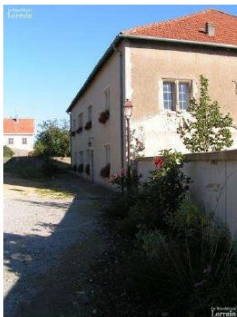
La maison a bien changé en 15 ans, mais la toiture reste à l'ordre du jour. Photo FL
